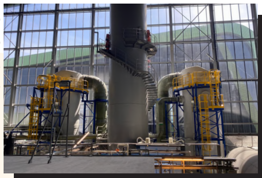
Instalacja odzysku ciepła ze spalin
