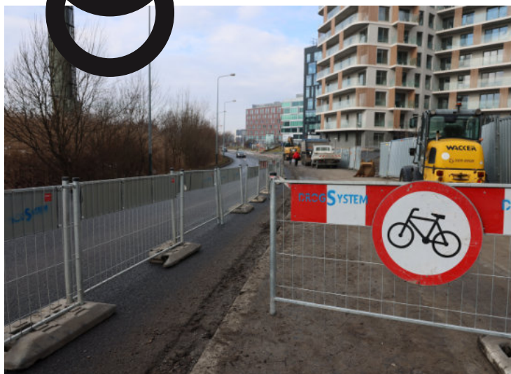
Do 30 kwietnia na ul. Puzkarskiej prowadzone będą prace związane z wymianą nawierzchni ciągu pieszo-rowerowego. Zadanie to jest realizowane w ramach „Paktu dla krakowskich osiedli” / fot. Jan Graczyński
