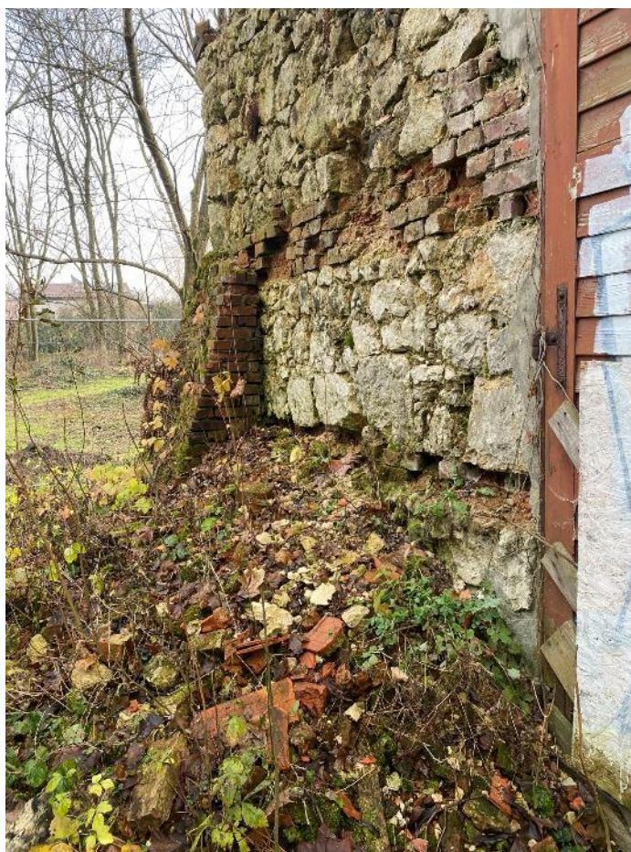
Fot. 11. Zniszczona (lecz stabilna) przypora narożnika północno-wschodniego.
