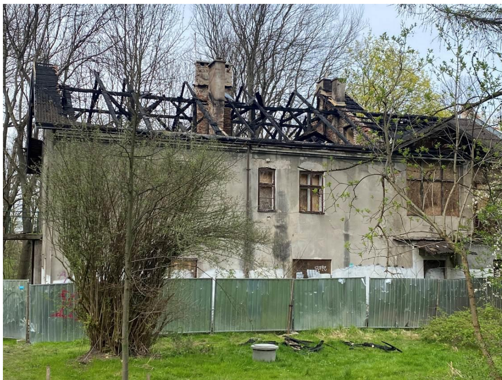
Fot. 12. Skala zniszczenia pokrycia.
