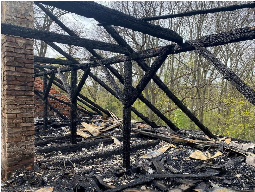
Fot. 13. Spalone elementy więźby dachowej
