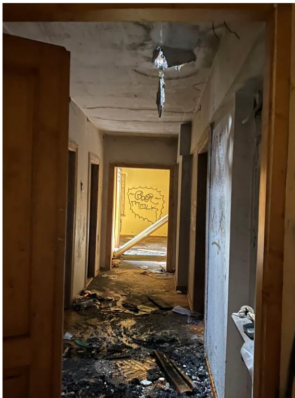
Fot. 16. Zalanie poziomu I piętra.
