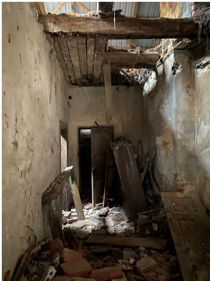
Fot. 8. Zdegradowana część gospodarcza – część środkowa dworu.
