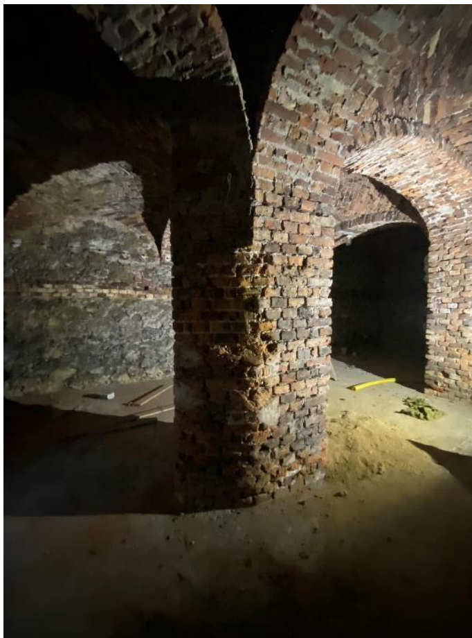
Fot. 9. Zdegradowane lecz stabilne sklepienia w wozowni.
