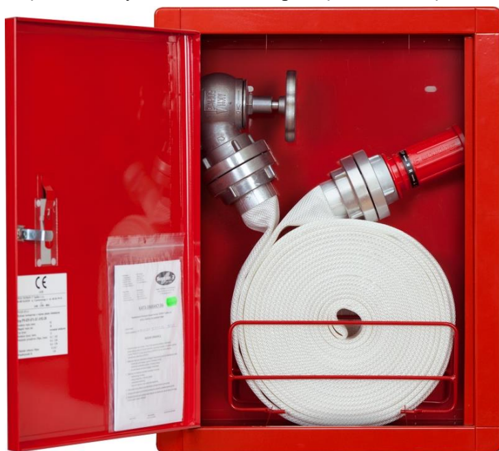
Hydrant wewnętrzny 52 z węzem półsztywnym
