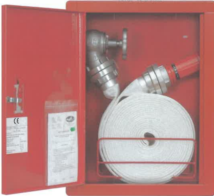
Hydrant wewnętrzny 52 z węzłem półsztywnym
