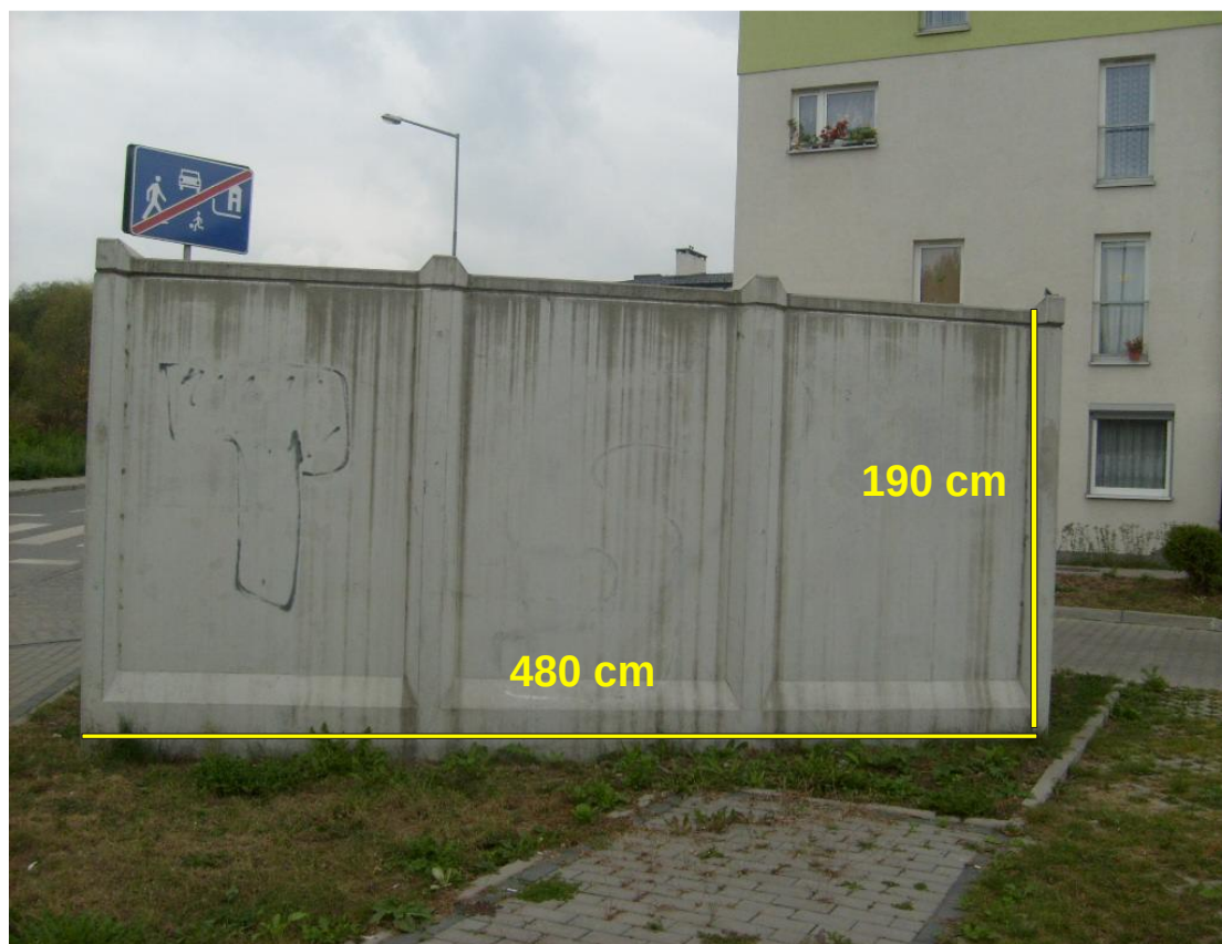
Wymiary altany śmietnikowej przed jej pomalowaniem
