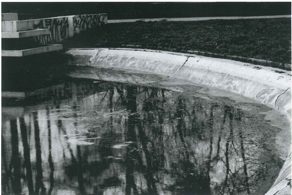
Woda w sadzawce w Parku Krakowskim została wpuszczona do brudnego i popękanego zbiornika. W tle widoczne graffiti którym wandalę zniszczyli fontannę. (stan na 29.03.2015, fot. Lech Mikulski)
