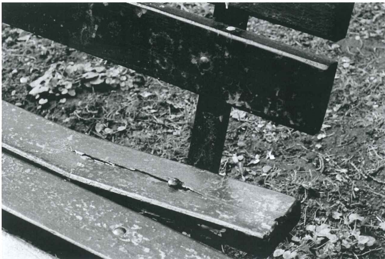
Uszkodzona ławka w Parku Krakowskim. (stan na 29.03.2015, fot. Lech Mikulski)
