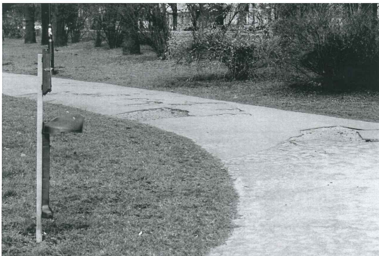
Pozostałość po koszu na psie odchody w Parku Krakowskim. W tle widoczne uszkodzenia alejki spacerowej. (stan na 29.03.2015, fot. Lech Mikulski)
