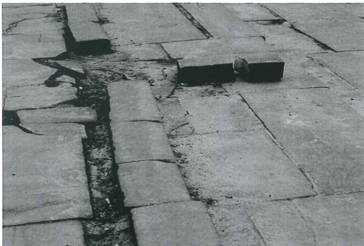
Uszkodzone schody do Parku Krakowskiego od strony Pl. Inwalidów. (stan na 29.03.2015, fot. Lech Mikulski)
